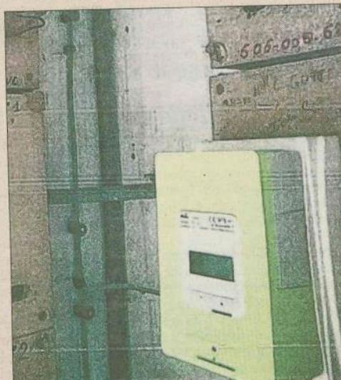
Dans cet immeuble, Linky a été posé sur des panneaux en bois. Photo Jocelyn PAU
